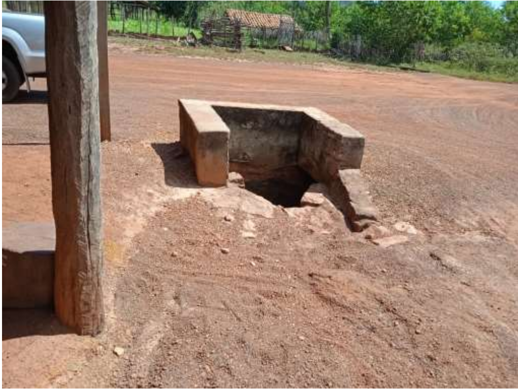
Imagem: Buraco prejudica a segurança de pedestres e veículos.
